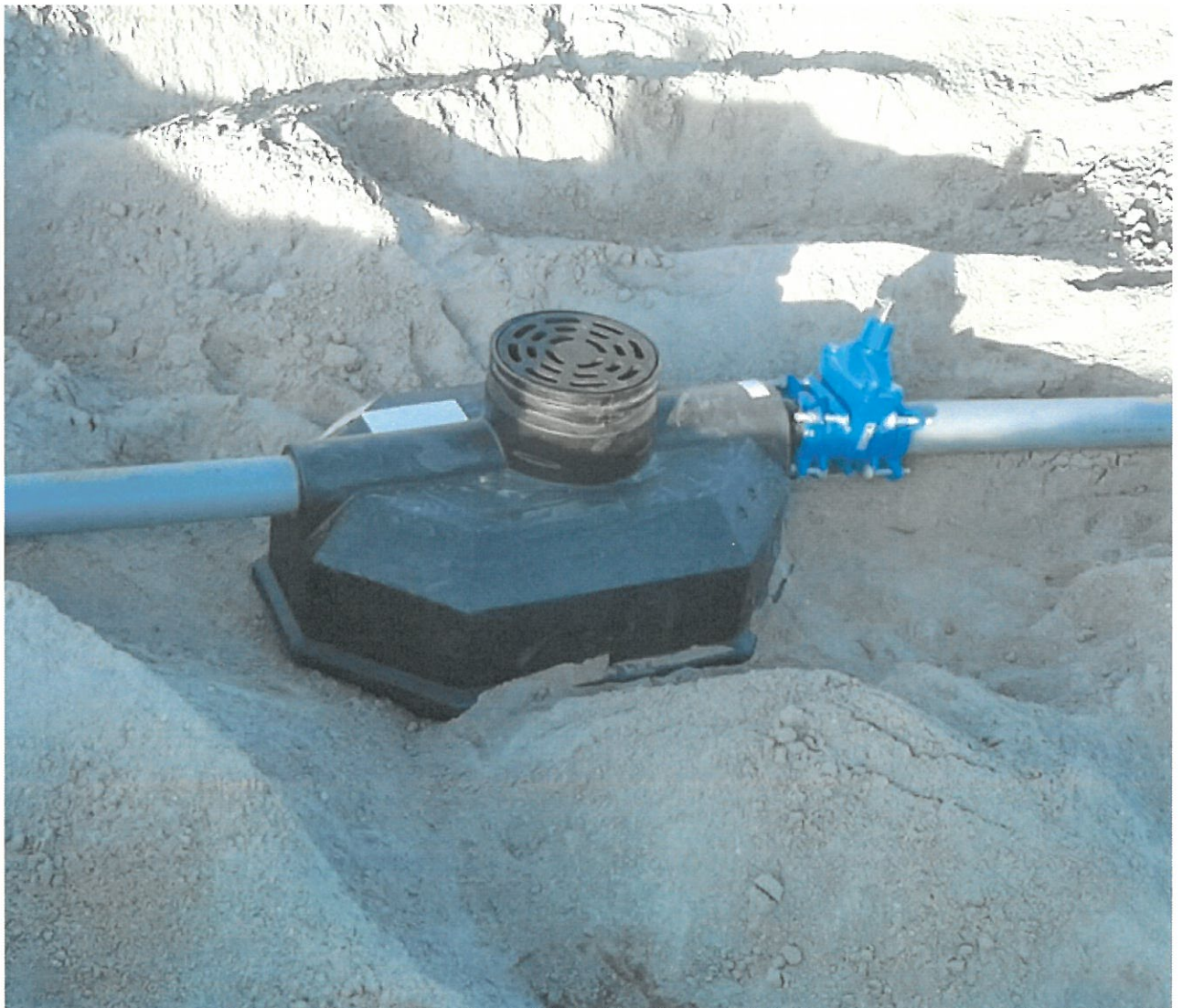
Jokkavaara murkauspaikan suojarakenteet. Kuvat Antti Ryhänen
